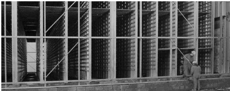
Stahlskelett der Halle mit Härte- und Trockenkammer; die Verkleidung erfolgt später – Montage kein Problem
